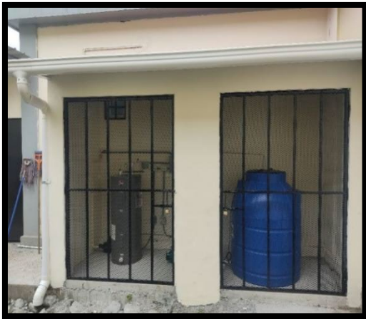
Ilustración 12. Caseta de Bomba de agua Morgue Judicial de Veraguas
